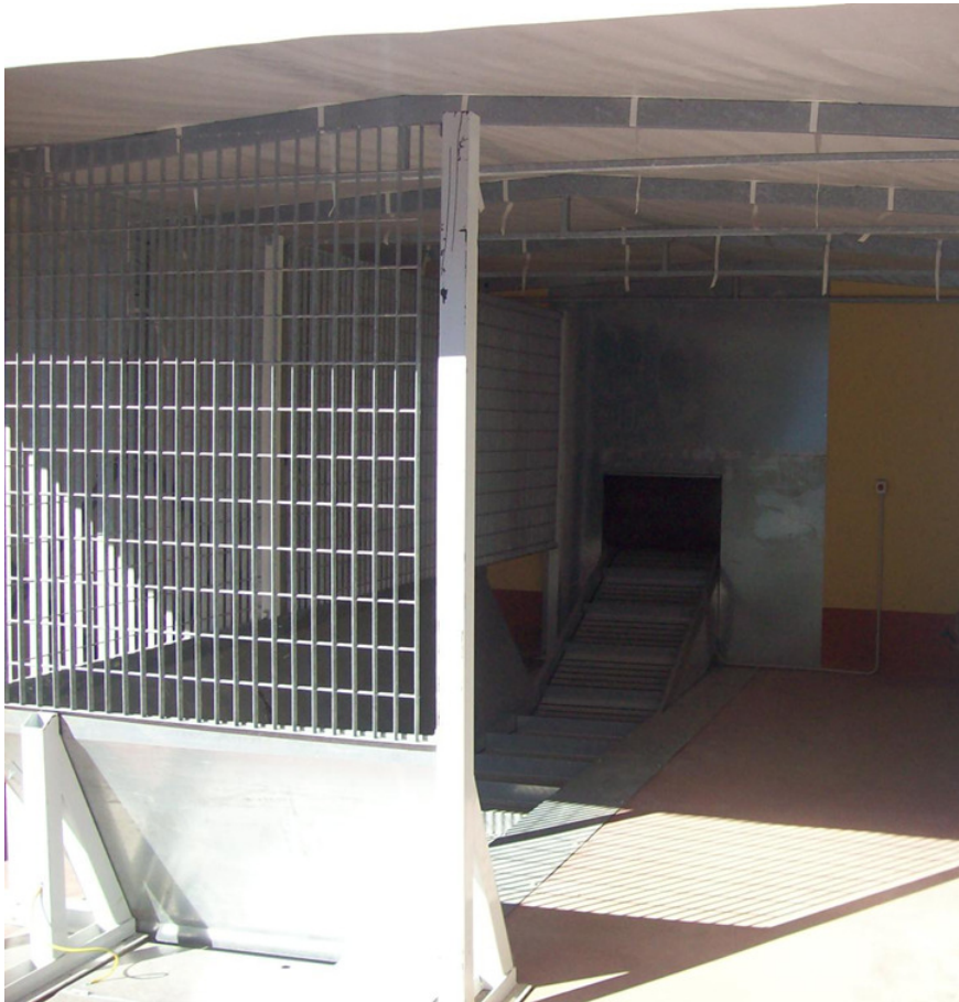
Figura 118 Tramoggia di scarico e tunnel mobile
